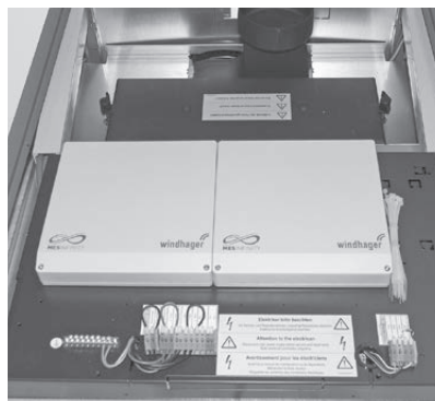
Fig. 76 Moduli funzionali (regolazione MES INFINITY) montati sul quadro di comando della caldaia
