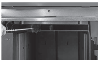
Fig. 56 Pulire l'aspirazione del gas distillato a bassa temperatura
